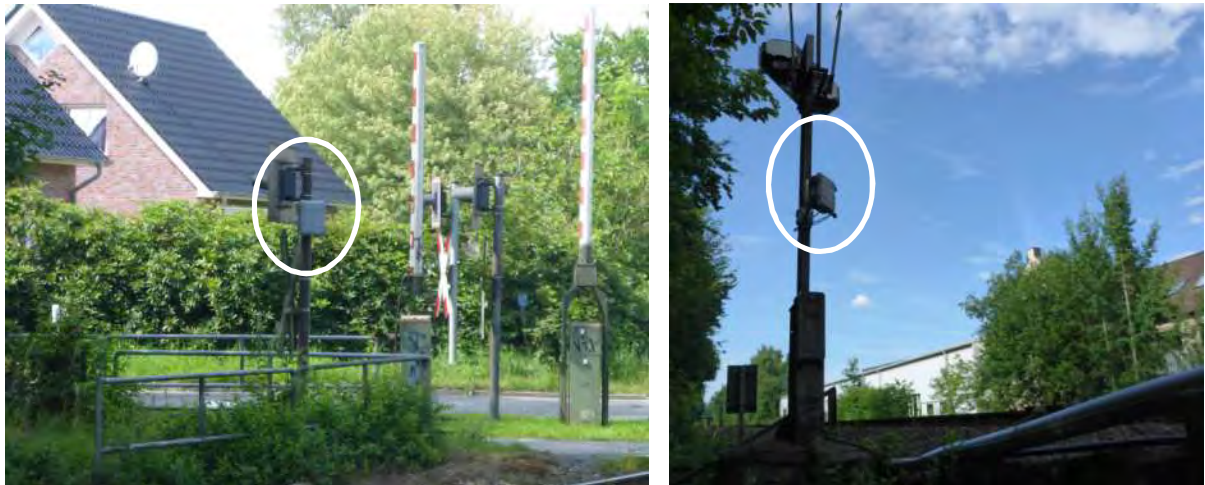
Abbildung 3-2: Installation des Seitenradarmesssystems an der Strecke 1522, BÜ km3,4 – Bürgerbuschweg (Radar 1) links; Melkbrink (Radar 2) rechts
