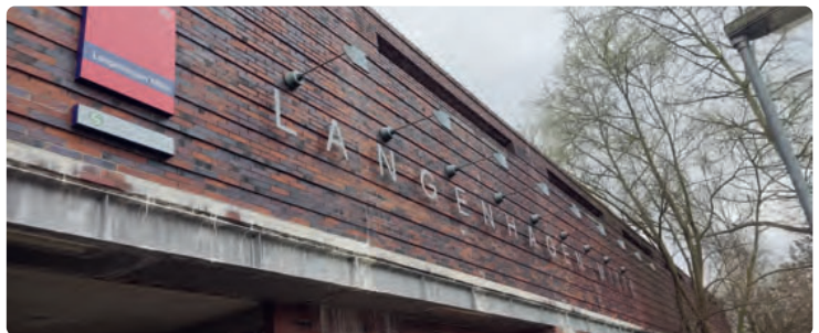
Aktueller Zustand der Außenfassade
