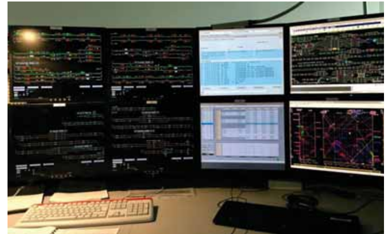
Elektronisches Stellwerk (ESTW)
